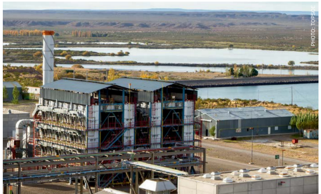
Fig. 2: 2,400 t/d ammonia cracker in Planta Industrial de Agua Pesada (PIAP plant)
