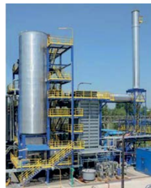
Topsoe WSA unit.
